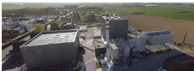
Cogénération Biomasse d'Estrées-Mons 1
